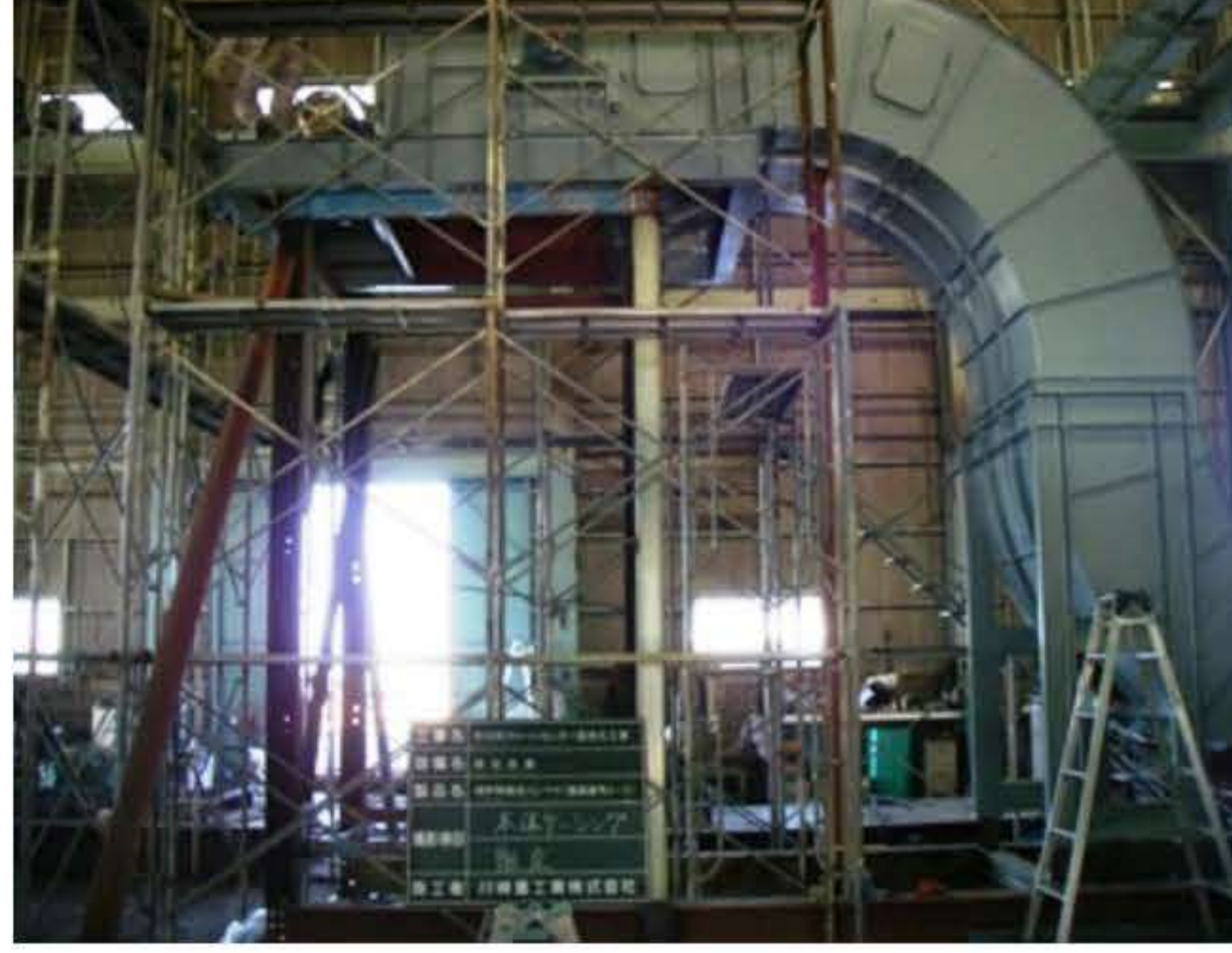
破砕物搬送コンベヤ
